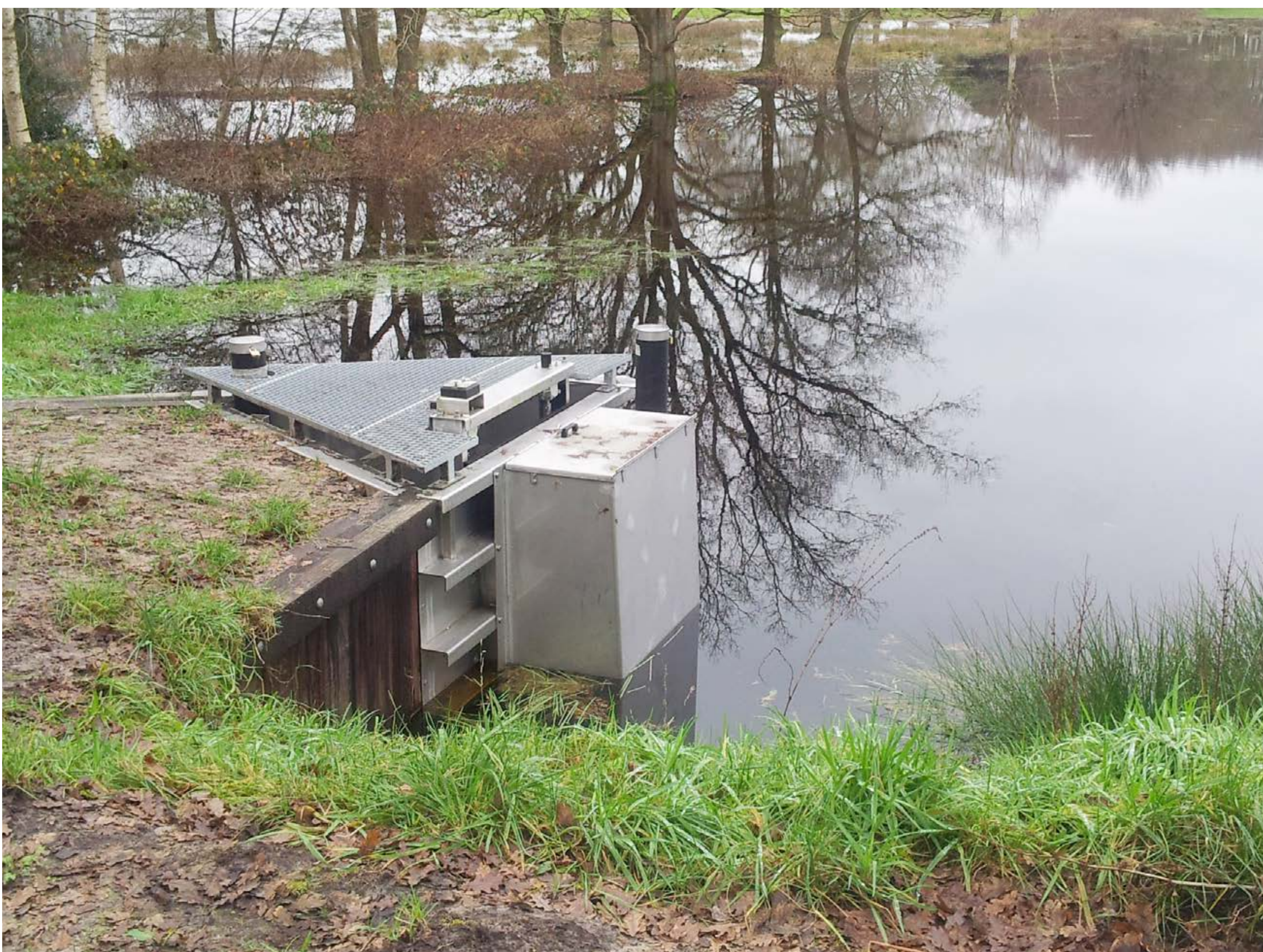
Voorbeeld van een knijpstuw
